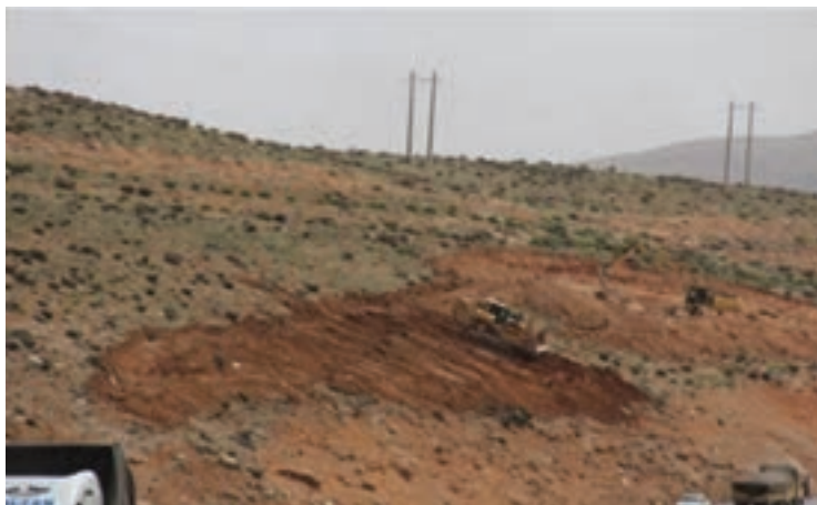
تصویر ۳-۱۵- مشکلات راه سازی در مناطق کوهستانی استان
